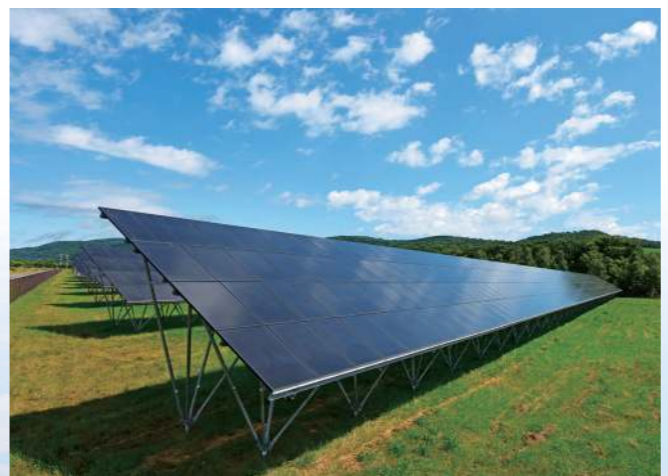
少雨で晴天の多い気候を生かしたメガソーラー発電施設
